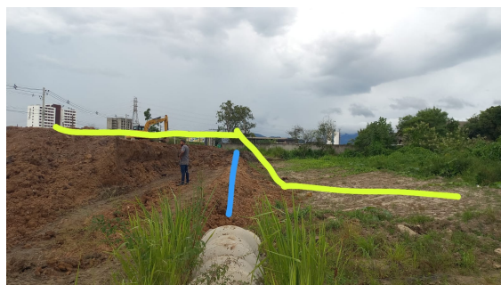
Figura 26 - Desnível após rompimento do aterro
