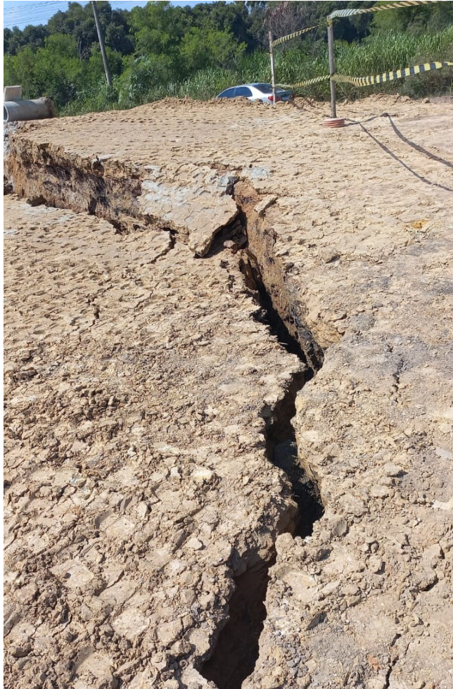
Figura 28 – Abertura no aterro após rompimento
