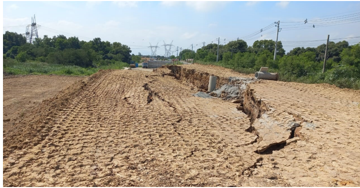
Figura 27 – Fissuras no aterro após rompimento
