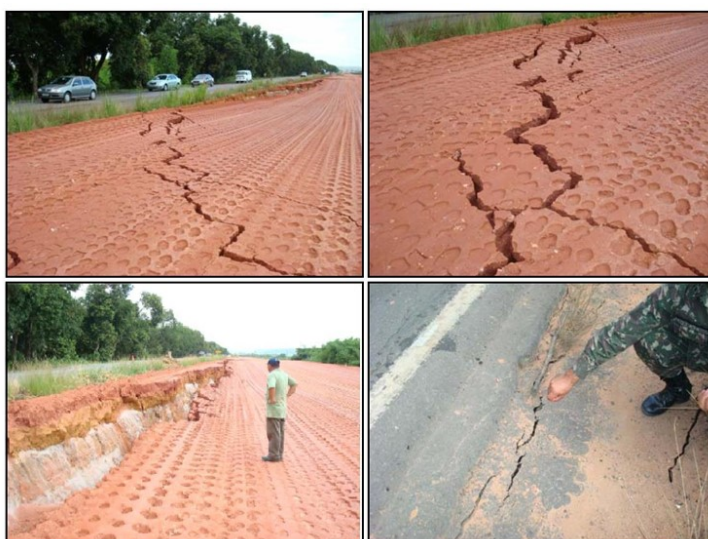
Figura 14 - Ruptura do aterro 5 – Segmento de aproximadamente 160 metros
