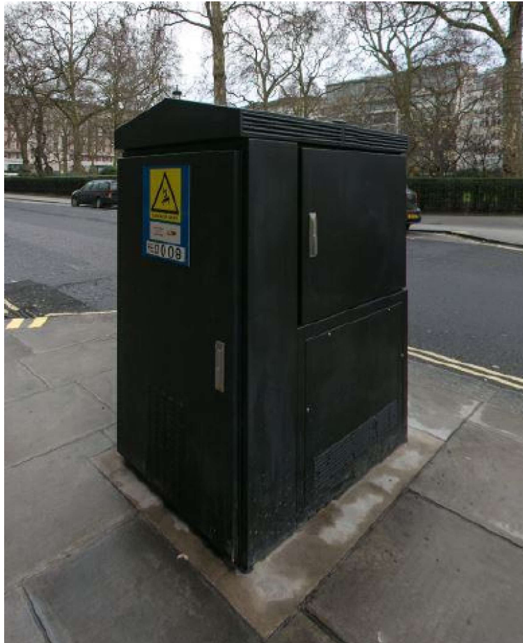
Figura 28 – SOP de dois terminais instalado em Portman Square
