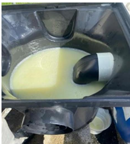
Figura 11 - Soro ácido retido na caixa de gordura
