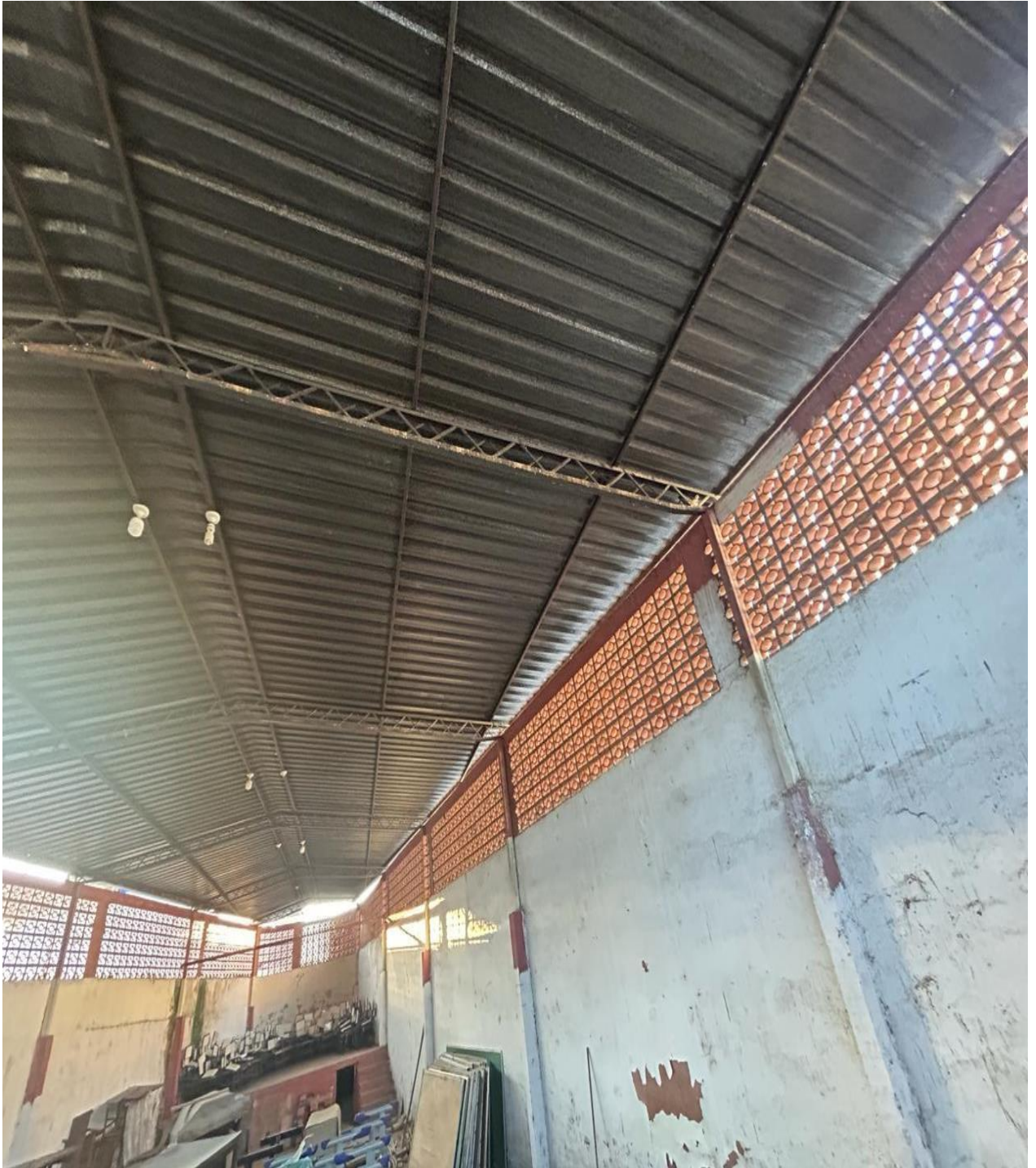
Imagem 2 – Espaço interno do anfiteatro da escola sem condições de uso
