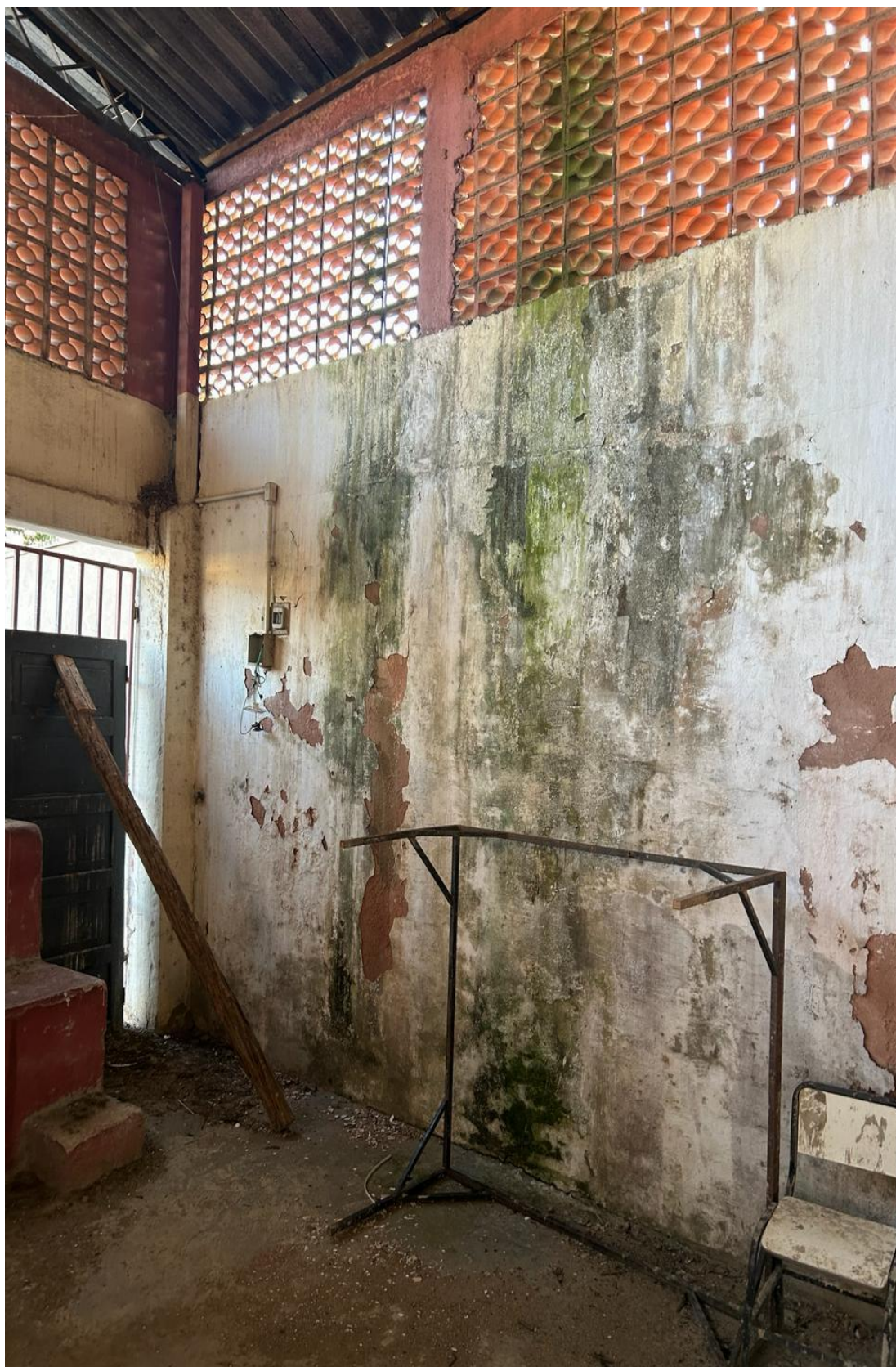
Imagem 4 – Espaço na escola em condições que podem colocar em risco a segurança de estudantes e funcionários
