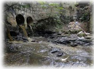
Figura 7- Descarte irregular de esgoto urbano.
